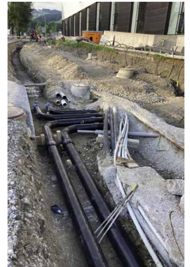
Anergienetz Altenrhein: Leitungs-Einführung BWB Oberflächentechnik AG
